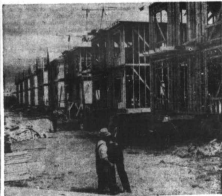
Sur les chantiers de la Coopérative d'habitation du Christ-Roi à Joliette, l'automne dernier.
